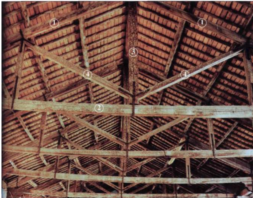
Figura 97. Armadura de cerchas. Estructura de parhilara. 1: Pares. 2: Tirante. 3: Pendolón. 4: Tornapuntas o jabalcones.
